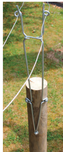
Alargador sobre poste madera.
